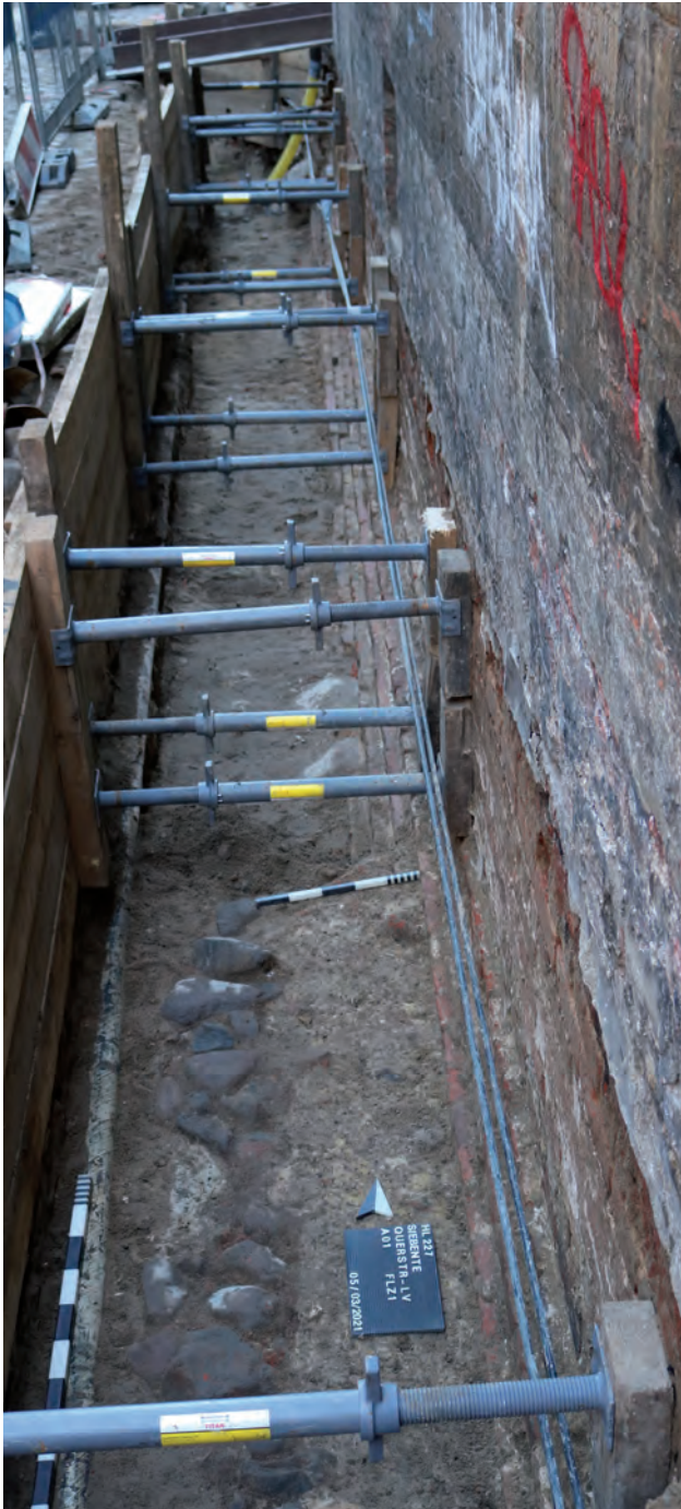
Abb. 46 Die Baugrube für das Backsteinfundament des heutigen Vorderhauses der Mengstraße 54 schneidet die vierte, erfasste Straßenpflasterlage der Siebenten Querstraße.
